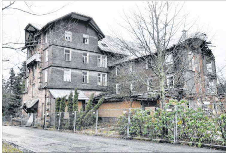
HUNDSECK UND KEIN ENDE: Über die Kurhaus-Ruine will die Gemeinde Ottersweier nun direkt in Stuttgart mit Landesoberhaupt Winfried Kretschmann und den zuständigen Ministern sprechen. Archivfoto: Margull
