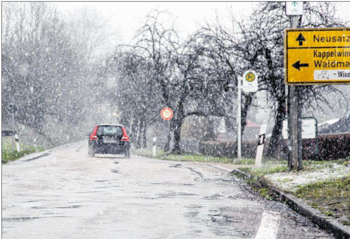
ZWISCHEN HUB UND NEUSATZ wird die L83a saniert. Die Schäden sind so gravierend, dass eine neue Fahrbahndecke aufgebracht werden soll. Foto: Margull
