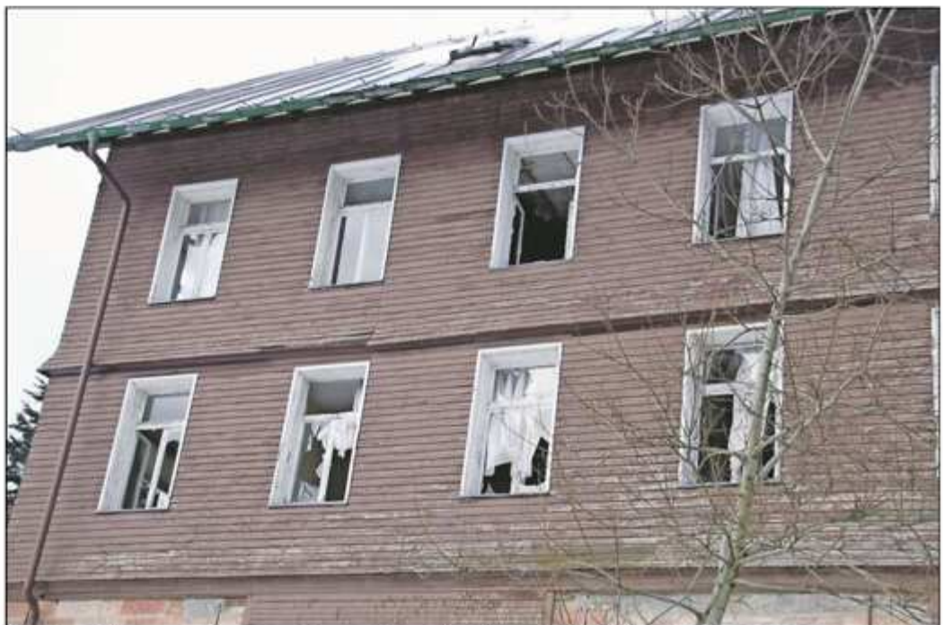
Tag der offenen Fenster: In den noch vorhandenen Gebäuden des ehemaligen Kurhauses Hundseck sorgen Sturm, Regen und Schnee für eine weitere Verschärfung der Situation.
