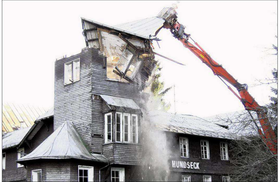
UNENDLICHE GESCHICHTE: Bereits im November 2012 wurden große Teile des ehemaligen Kurhauses Hundseck abgerissen. Der Fall beschäftigt aber Politik und Behörden nach wie vor. Ein Abbruch der restlichen Ruine steht aus. Archivfoto: Coenen
