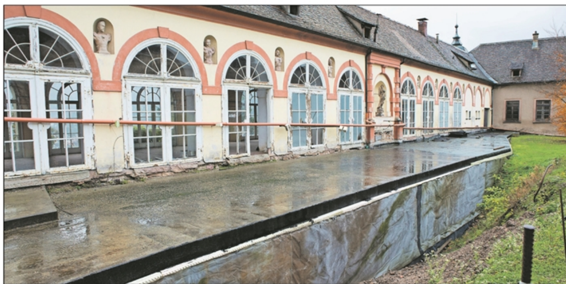
Trauriges Bild: Fenster und Fassade der Orangerie sind teils kaputt, die Baustelle davor liegt brach.
